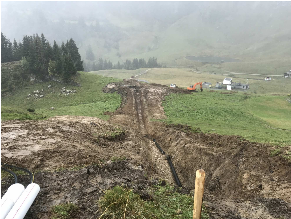
Côté Léchereuse, les fouilles des futures conduites sont bien engagées. © Le Nouvelliste
